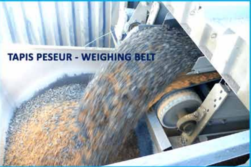
SAND HUMIDITY PROBES SONDES D'HUMIDITE DANS LES SABLES
